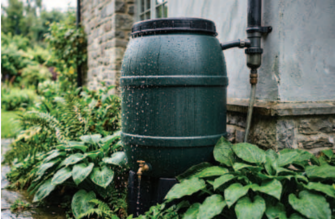
Regenwasser als kostenlose Ressource kann dabei helfen, Trinkwasser zu sparen und die Umwelt zu entlasten.
