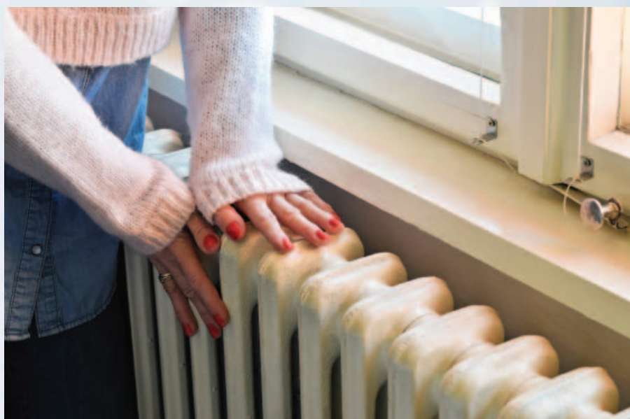
Der hydraulische Abgleich sorgt für gleichmäßige Wärmeverteilung.
