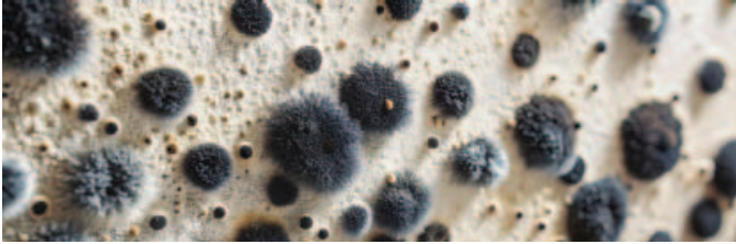
Wenn Schimmelsporen einen Nährboden und ausreichend Feuchtigkeit zur Verfügung haben, können Pilze wachsen.
